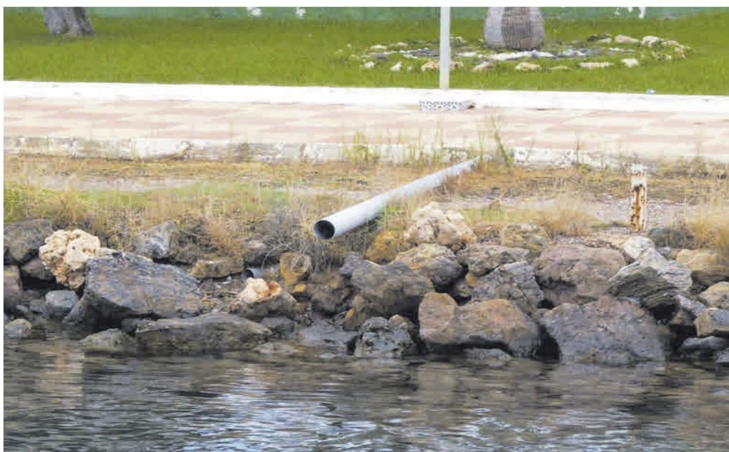
Una tubería que vierte en el Mar Menor.
